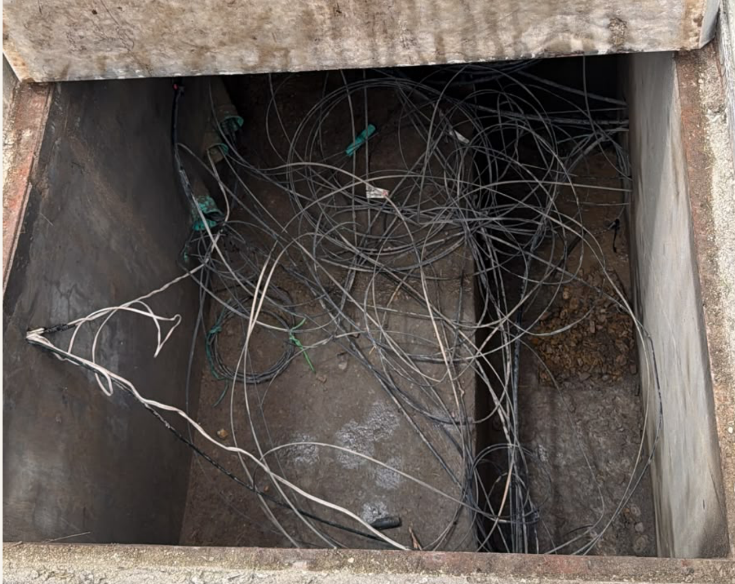
Caja de comunicaciones del Conjunto con cableado adicional no autorizado.
